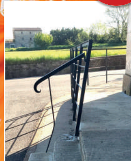
Dégradation de la rampe de la chapelle d'Aubarne qui sera réparée par notre service technique.
