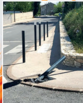
De nombreux potelets renversés par des automobilistes et réparés par nos Agents Techniques
