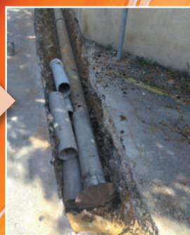
Dépôt sauvage de conduits de cheminée en amiante dans la tranchée du chantier de pluvial Rue de l'Eglise à Russan
