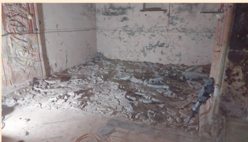
Les morceaux de dalle avant évacuation
